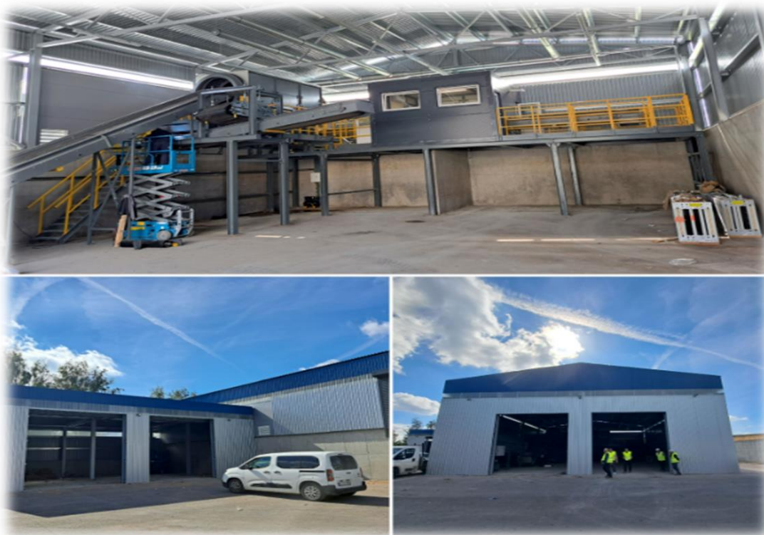
2 pav. Baigiama rekonstruoti bioskaidžių atliekų stoginė ir komposto brandinimo aikštelės dalis įrengiant maisto/virtuvės atliekų rūšiavimo liniją
